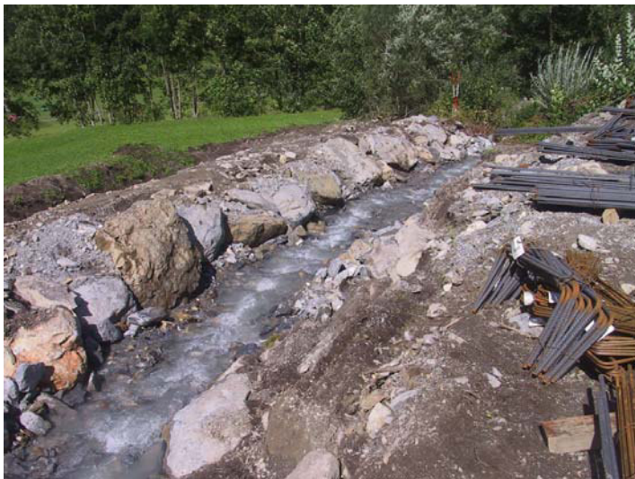
26.8.2011: Der Mattenbach plätschert im Umleitungsgerinne friedlich dahin, .....bis zum nächsten Gewitter.
