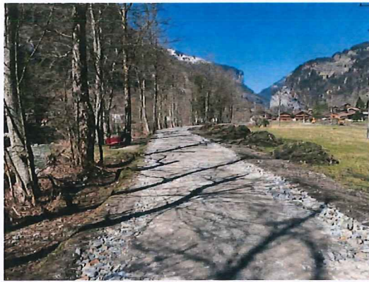
Abbildung 20: Unterhaltsweg UW Heliport
