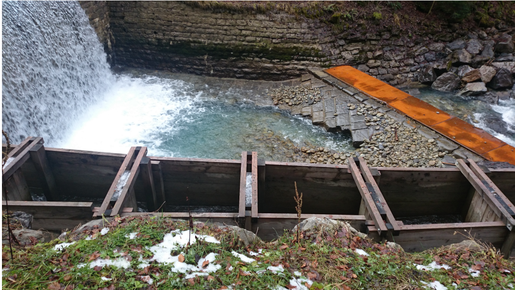
Abbildung 2: Unterspülung der Vorsperre. Foto: Ralf Schai.
