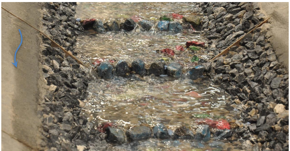
Abbildung 78: Stufen Nr. 6 bis 8 nach der HQ_{300} -Überlastfall-Ganglinie. Gut zu erkennen sind die einzelnen Lücken zwischen den Blocksteinen, durch welche die Fische die Stufe überwinden können.
