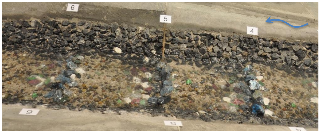
Abbildung 86: Stufen Nr. 4 bis 6 nach HQ_{300} -Überlastfall. Der oberwasserseitige Erosionsschutz wurde teilweise ausgetragen.
