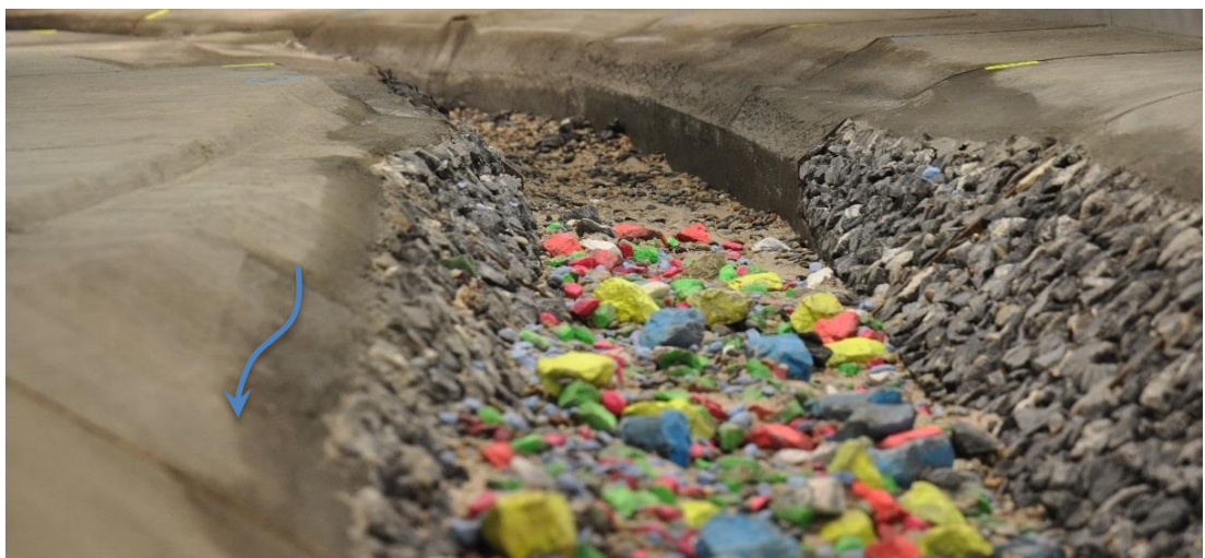
Abbildung 14: Blick Richtung Zulauf nach Kollaps der Sohle.
