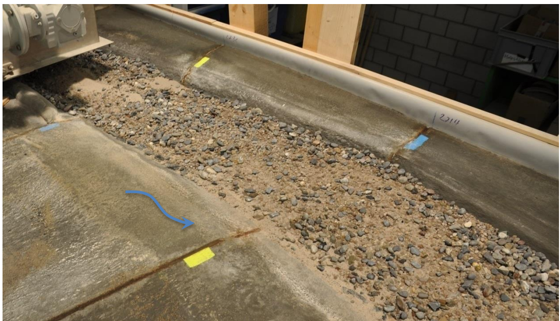
Abbildung 32: Sohle im Zulaufbereich nach Teilversuch A1_02.1_HQ100G, Blöcke und Sohle mit Geschiebe verfüllt.
