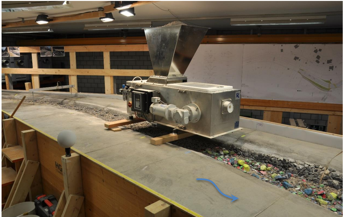
Abbildung 33: Bandwaage an neuer Position.
