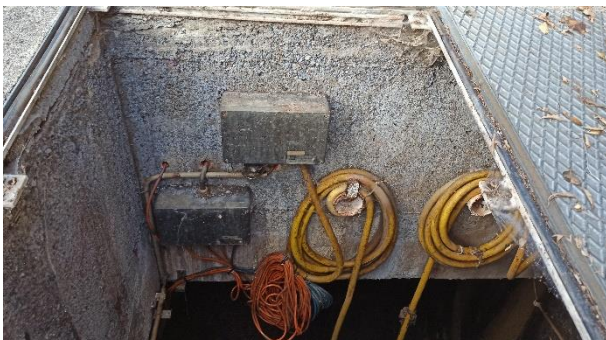
Alte Dosen und Kabel
