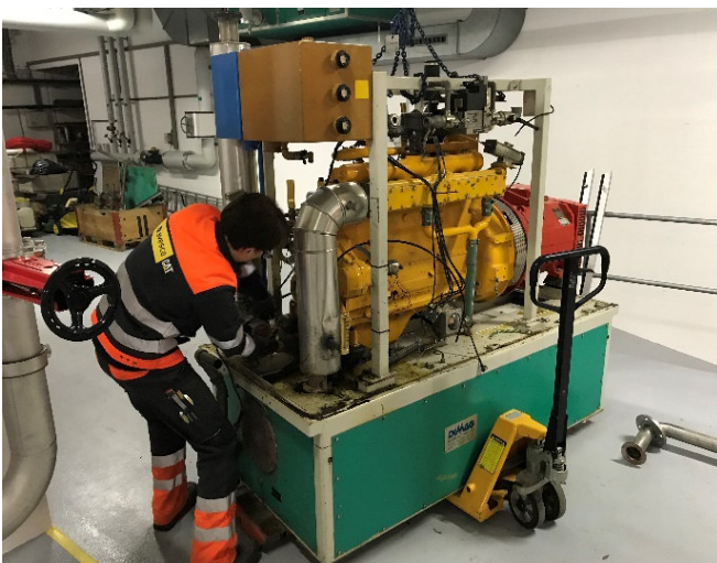
Fertig montiertes, neues BHKW
