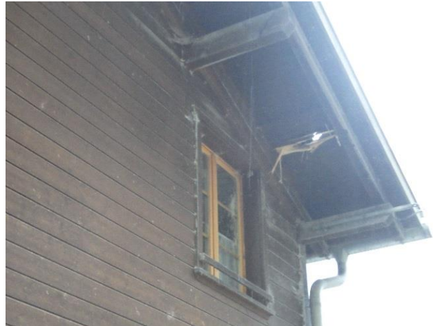
Schaden an Liegenschaft Gertsch
