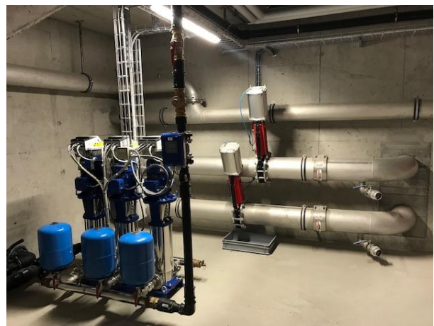
Brauchwasseranlage im Technikraum
