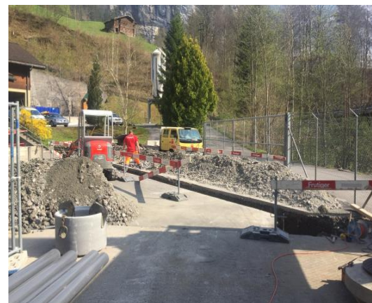
Neue Leitung Chemikalieneinfüllstation
