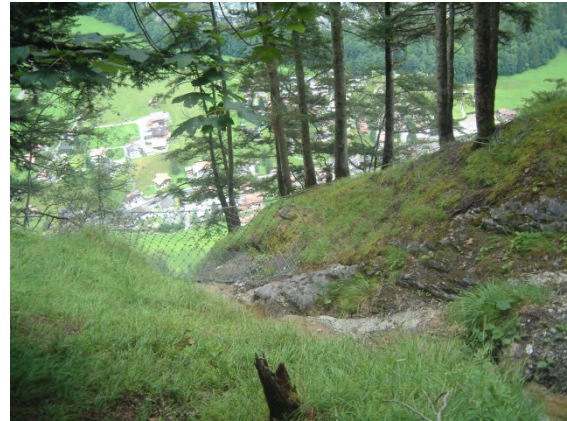
Steinschlagschutznetz auf der Fluh, für den Zugang Staubbachhubel
